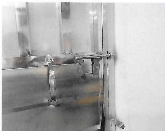
[南]实验楼 201（整改前）
