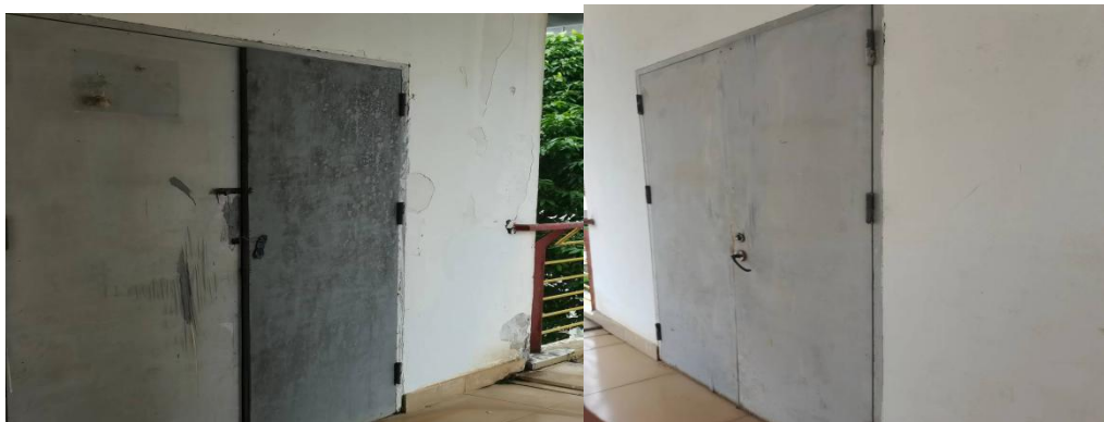
外语学院三楼、四楼楼层部分配电房门。
