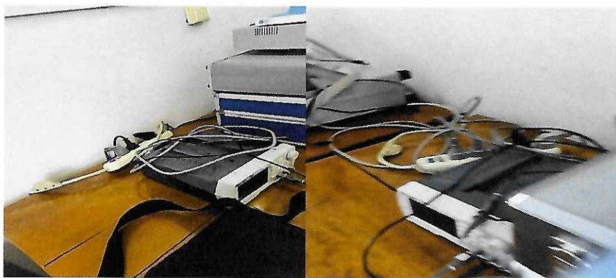
505 电插座电应有效固定，不要直接放桌面上，且不能超负荷
